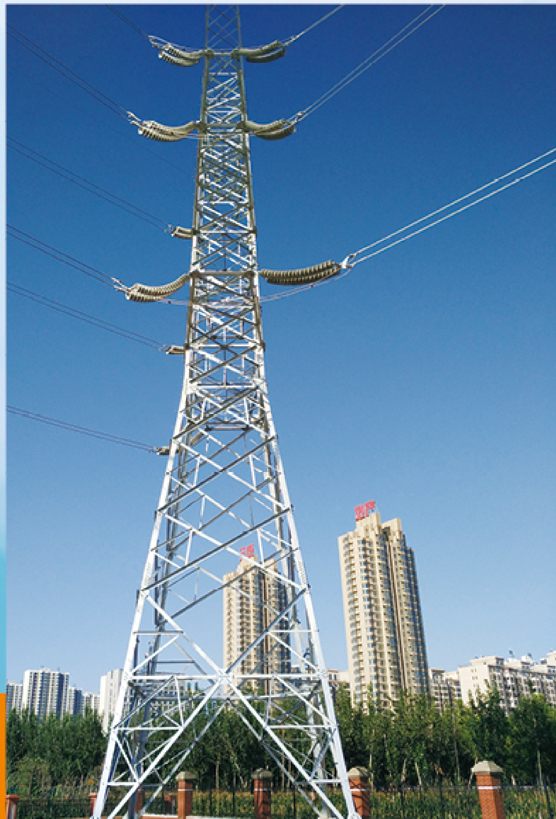
220kV 线路铁塔
